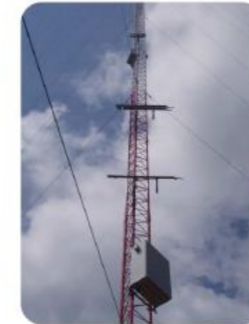
Vue du mât avec ses haubans et ses 2 panneaux solaires (plaques horizontales)
